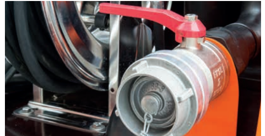
C-Anschluss mit Absperrhahn und freier Fließstrecke
